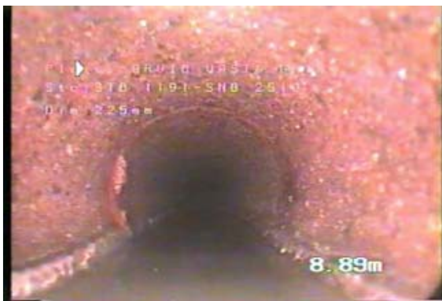
Fig 8 Bildexempel spillvattenledning 225 mm.
