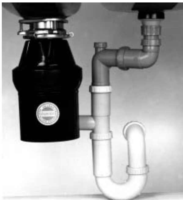
Fig 6 Köksavfallskvarn monterade under diskbänk.
